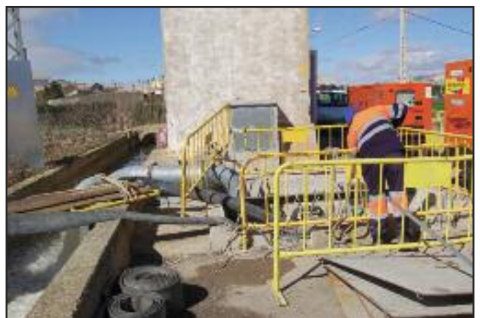
Las bombas de achique aminoraron la incidencia de la riada en el casco urbano utebero.
